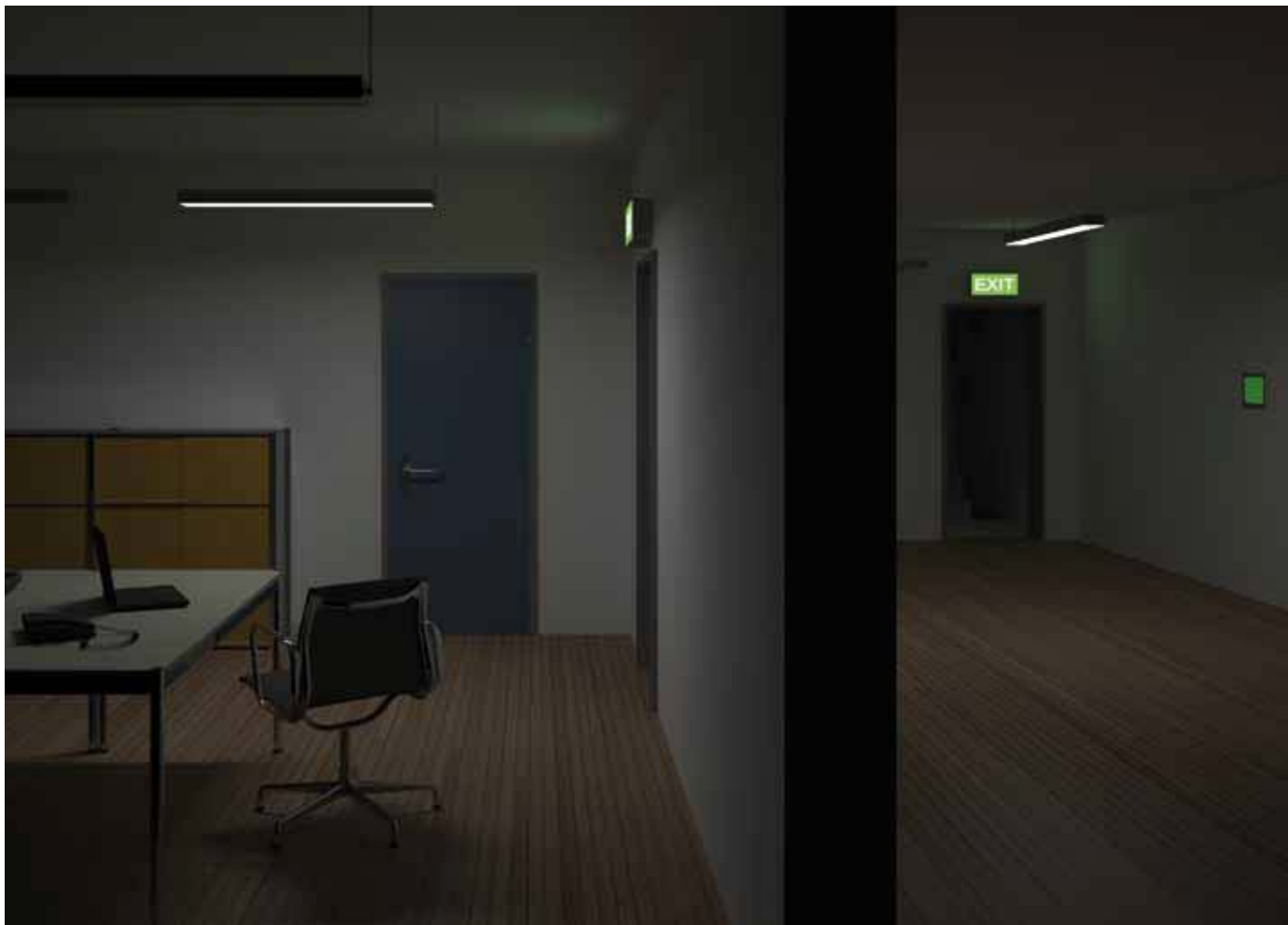
Valamennyi tartalékvilágítási lámpatest központi vezérlése e-touchPANEL-ről
